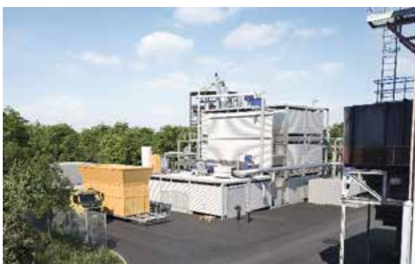
発電出力2,000kW、発電効率29% 熱出力2,300kW、ウッドチップ1日64トン
